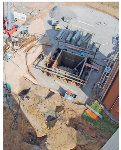
Für den Neubau des Gasbehälters und eines Funktionsgebäudes sind die Fundamente vorbereitet.
